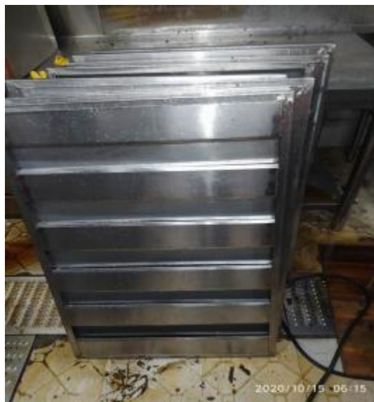
防火板清洗后
