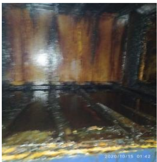
净化器机箱清洗前
